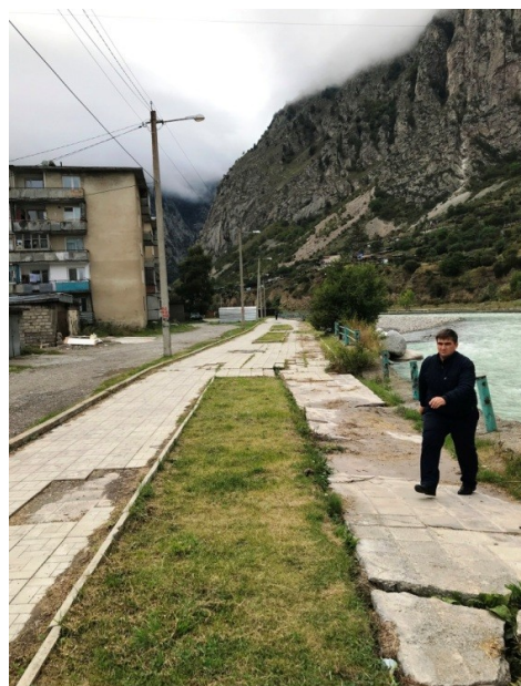
Рисунок 8 – Место повреждения (деформации) правобережной защитной бетонной стены и участка набережной реки Баксан с пешеходной дорожкой
