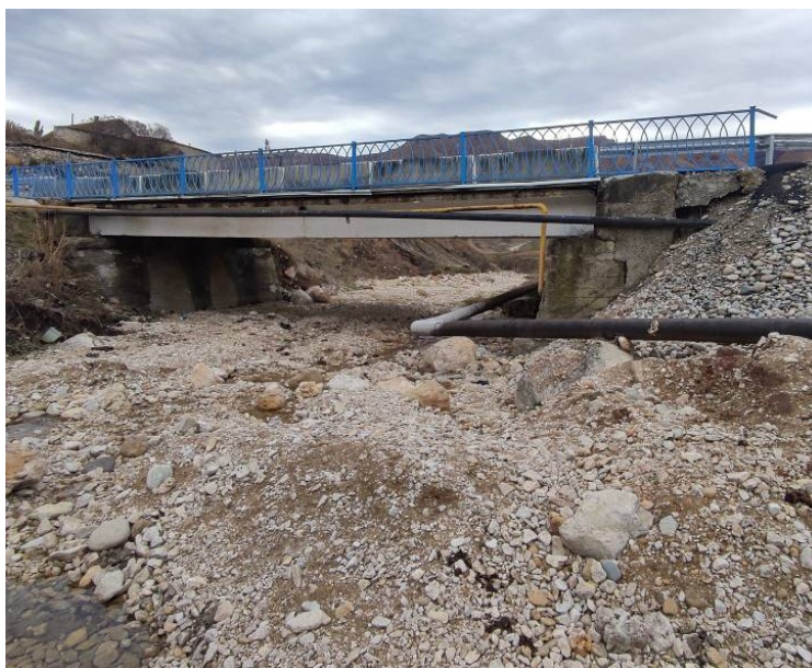
Рисунок 4 – Отложения грунтово-каменных масс в районе автомобильного моста в с.п. Хабаз
