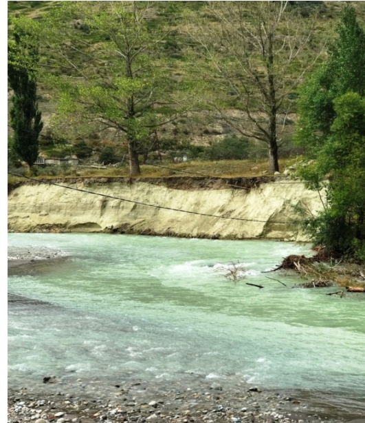
Рисунок 4 – Участок подмыва (размыва) откоса дамбы хвостохранилища №1 с обнажением тела складированных здесь отходов обогатительной фабрики ТВМК. Проблемы: частично разрушен участок дамбы хвостохранилища и складированные здесь экологически вредные отходы обогащения смываются левым рукавом реки (рукав образован в результате чрезмерного накопления донных отложений в середине русла реки Баксан), угроза дальнейшего развития размыва откоса дамбы и повреждения расположенных на этом участке левобережных опорных конструкций и фундаментов вантового пешеходного моста и вантового перехода с инженерными сетями через реку Баксан
