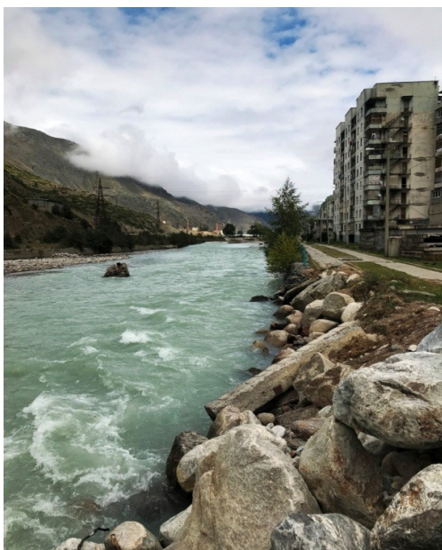
Рисунок 7 – Место разрушения правобережной защитной бетонной стены. Проведены аварийные берегоукрепительные работы
